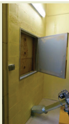
Chaufferie bois à pellets
